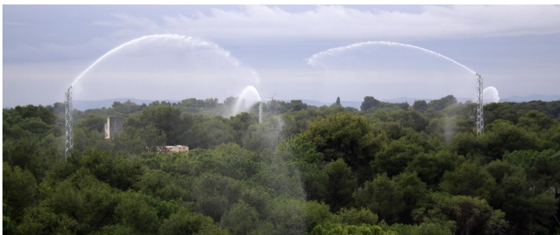
Figura 4. WUIPROTECT® Wildfire Defence System instalado en el perímetro de una interfaz urbano-forestal. Fuente: Medi XXI GSA
